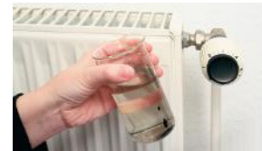
Mit permasolvent® magno behandeltes Heizungswasser
