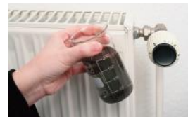
Unbehandeltes Heizungswasser mit Magnetitschlamm
